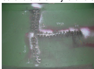
Scheur in pomp gedeeltelijk gerepareerd
